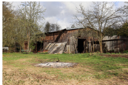
Scheune am See (baufällig)
